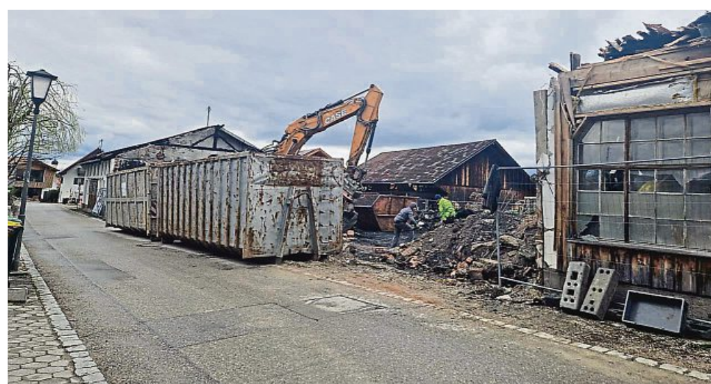
Das Grundstück an der Ludlmühlstraße wird aktuell gereinigt. Die Flammen hatten die alte Schreinerei am 28. November in Schutt und Asche gelegt. FOTO: MOH
